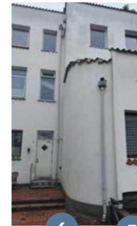
Tagnedløb 4 afvander en del af den store tagflade på bygningen mod Slangstrupgade. Tagfladearealet er 340 m 2 .
