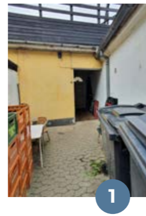
Tagnedløb 1 afvander tagfladearealet/tagterrassen der vender mod Køies Bugt, et areal på ca. 45 m 2 . Desuden afvander tagnedløb 1 tagfladearealet mod øst på ca. 45 m 2 .
