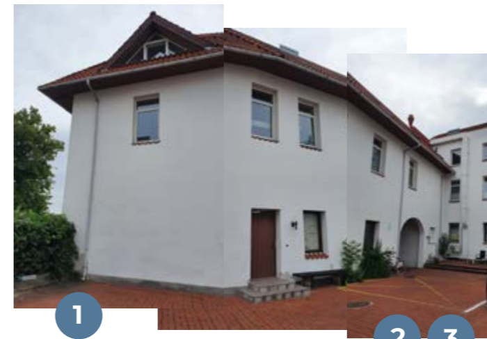
Tagnedløb 1, 2 og 3 afvander et tagfladeareal svarende til ca. 115 m 2 . Bygningens øvrige tagflader afvandes mod Slotsgade.
