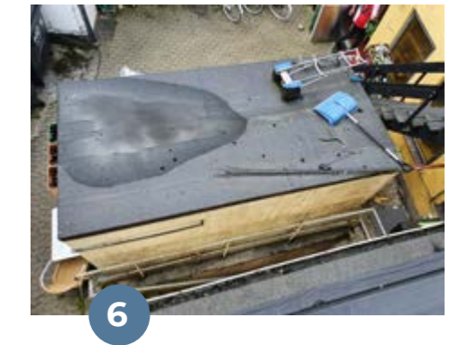
6 det store kølerum der står i baggården, har ikke noget nedløbsrør og vandet ligger i en lille lunke på det flade tag. Tagfladens areal er ca. 10 m 2 .
