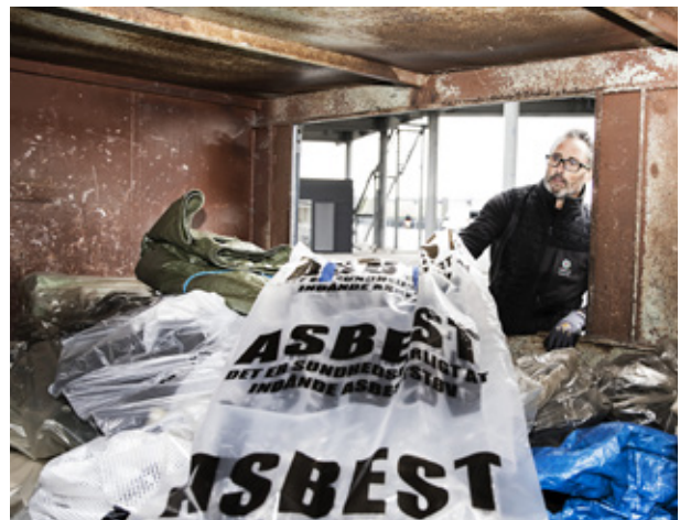
Asbestplader forsvarligt pakket ind
